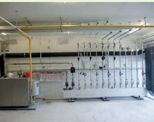
Heizung: Schweizer Präzision unter der Leitung von Kurt Kuhn.
